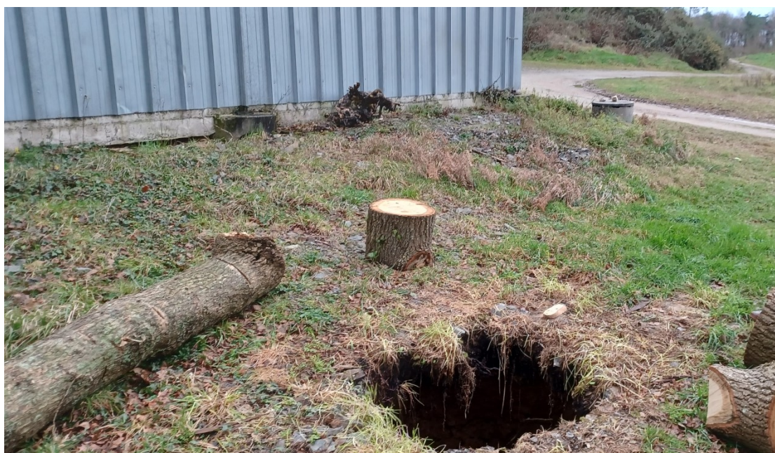
Effondrement de la galerie -27m près du grand hangar en décembre 2021
